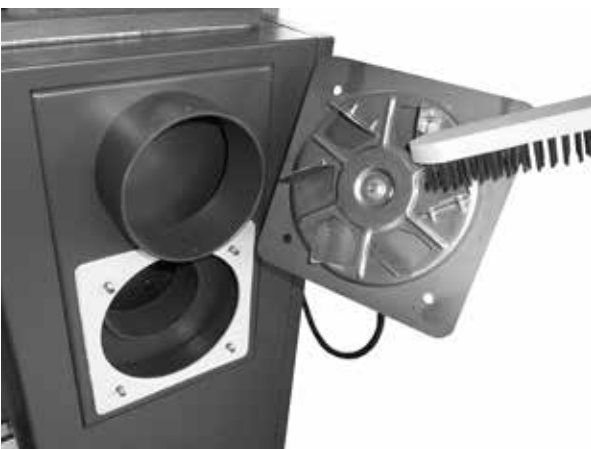
Ukázka čištění oběžného kola a kontrola kolmosti lopatek odtahového ventilátoru
