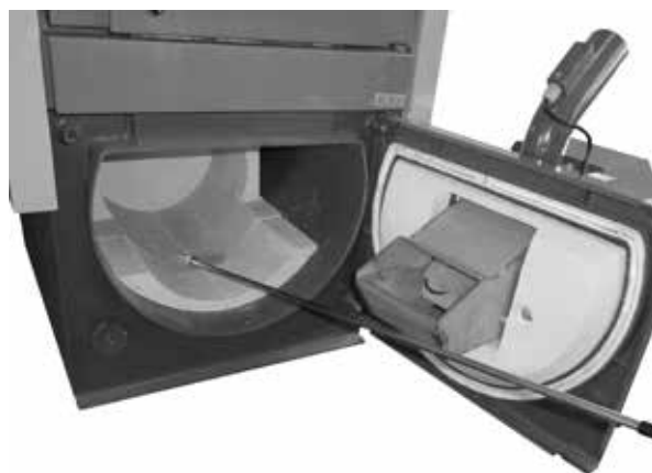
Otevřená spodní dvířka kotle pro čištění spalovací komory kotle při topení peletami
