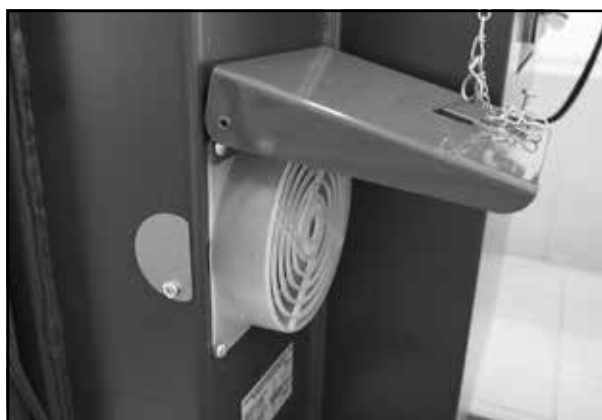
Otevřená (nastavená) klapka pro přívod spalovacího vzduchu do kotle
